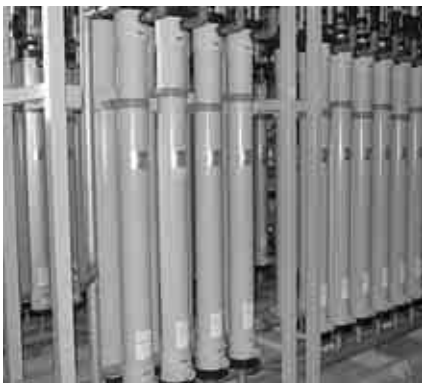
写真2 排水回収用膜処理装置
