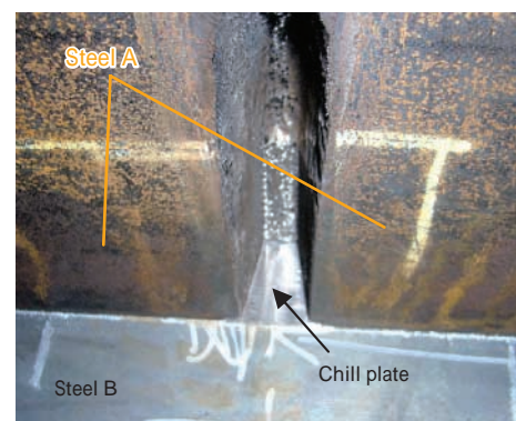
図 6 試験体 2 の溶接前の D 部 Fig. 6 Area "D" in Fig.4 before welding for specimen 2
