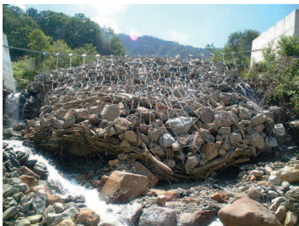
図7 ワイヤーネット工による土石流捕捉状況 Fig. 7 View of trapped debris flow by wire net dam
