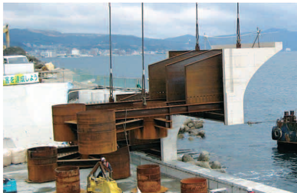
図16 上部フレアブロックの据付 Fig.16 Installation of upper flare-shaped block
