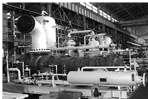
図6 水素ガス圧縮機ユニットの外観
