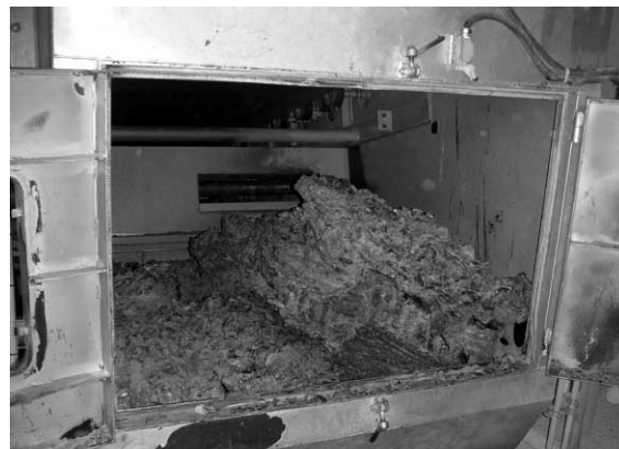
図2 1次クラッシャ内のクリンカ大塊 Fig. 2 Large mass of clinker in clinker crusher
