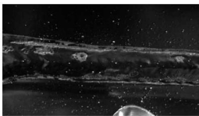
図6 塗装済みアーク溶接部に発生した錆
