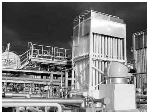
図6 運転中の消霧装置付き自然通風型空温式気化器外観 3) Fig. 6 Natural draft vaporizer with de-fog system in operation 3)
