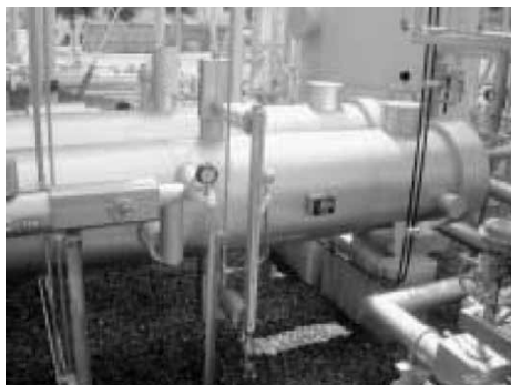
図2 運転中の円筒型温水バス式気化器外観 1) Fig. 2 Hot-water bath vaporizer in operation 1)
