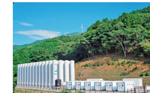
図3 圧縮空気エネルギー貯蔵システムの1MW大型実証設備 Fig.3 Large-scale test plant (1MW) for compressed air energy storage system
