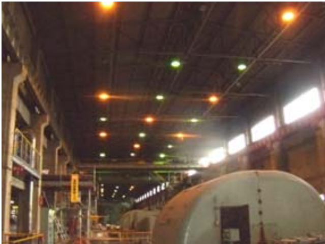
工場内照明例(改造前)
