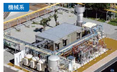
機械系 下水道バイオガス都市ガス導管注入設備 バイオガスの有効活用 下水汚泥から発生するバイオガスを家庭用(都市)ガスと同等の品質に精製するための都市ガス化設備
