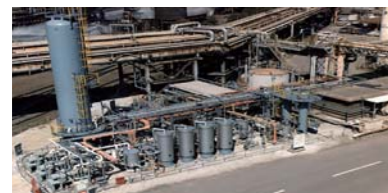
加古川製鉄所CO-PSA商業プラント 製品CO流量150Nm 3 /hr
