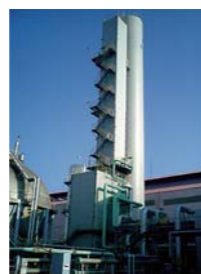
鉄鋼メーカー向け空気分離装置
