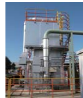
真岡製造所のVOC除去設備
