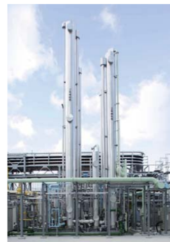
バイオ天然ガス化設備
