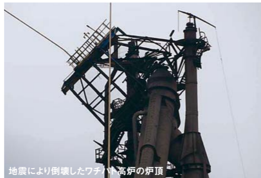
地震により倒壊したワチパト高炉の炉頂
