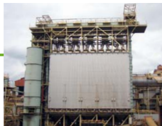
▲焼結工場の排煙脱硫脱硝設備
