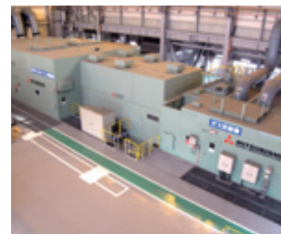
▲高効率ガスタービン発電設備(加古川製鉄所)
