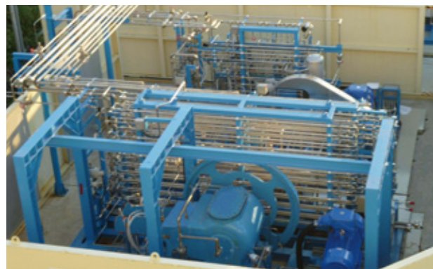
▲直接充填方式水素ステーション用高圧水素圧縮機
