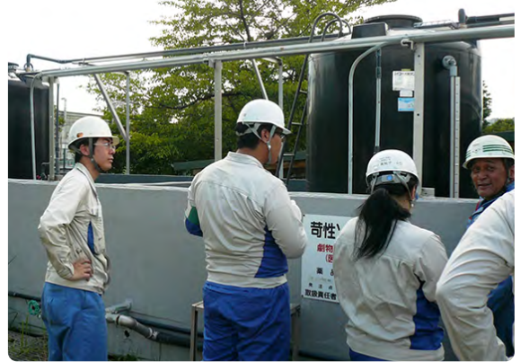
▲ 環境監査にて、排水処理施設の管理状況を確認（茨木工場）
