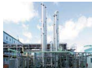
バイオ天然ガス化設備
