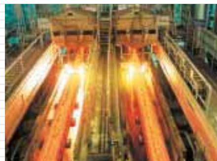
第5号連続鋳造設備
