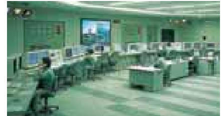
神鋼神戸発電所(中央操作室)
