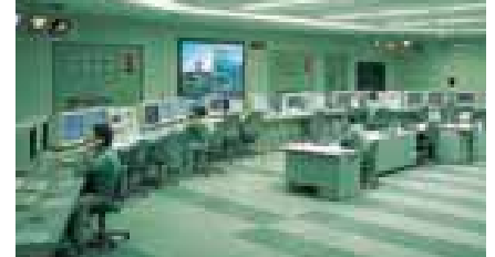
神鋼神戸発電所(中央操作室)
