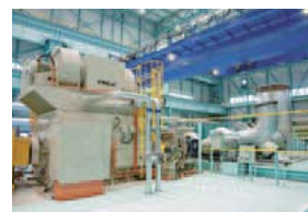
大型圧縮機試運転設備
