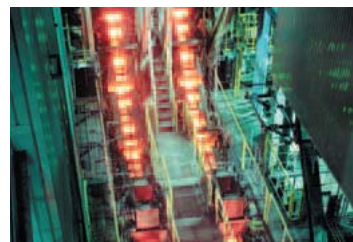
神戸製鉄所 第5連続鑄造設備
