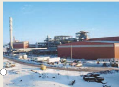
商業第1号プラントの全景
