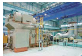
大型圧縮機試運転設備
