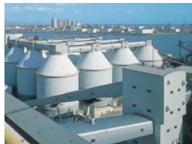
神鋼神戸発電所 石炭サイロ
