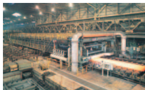
現状の厚板加速冷却設備
