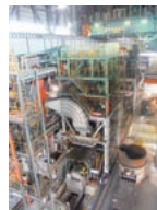
新溶銑処理設備
