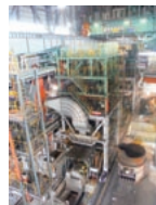
新溶銑処理設備
