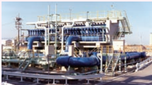
オープンラック式LNG気化器「ORV」
