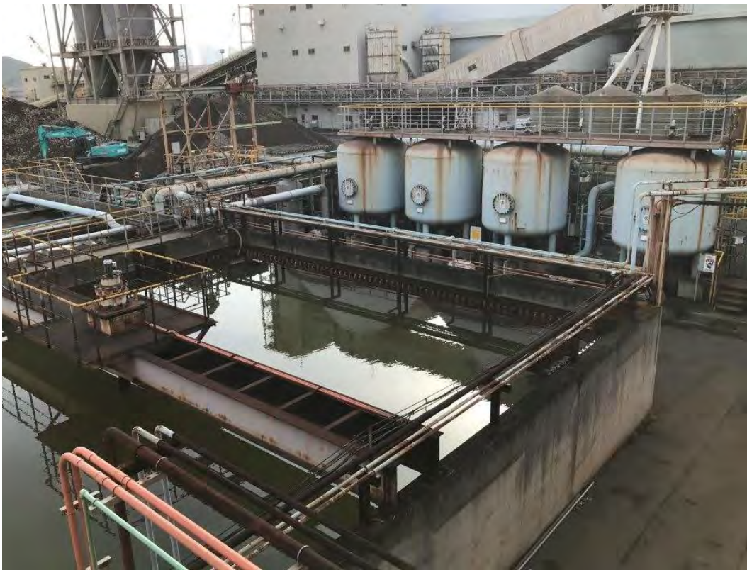
写真 4.4-1 工事排水処理設備の設置状況
