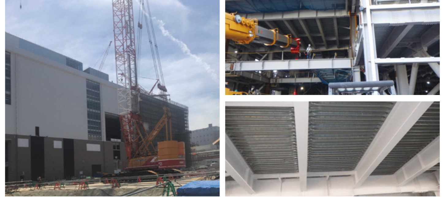
■神戸製鋼所神戸発電所(兵庫県)・・・デッキ
