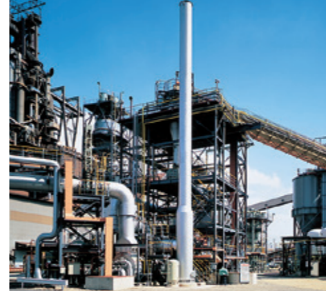
高炉用微粉炭吹込設備
