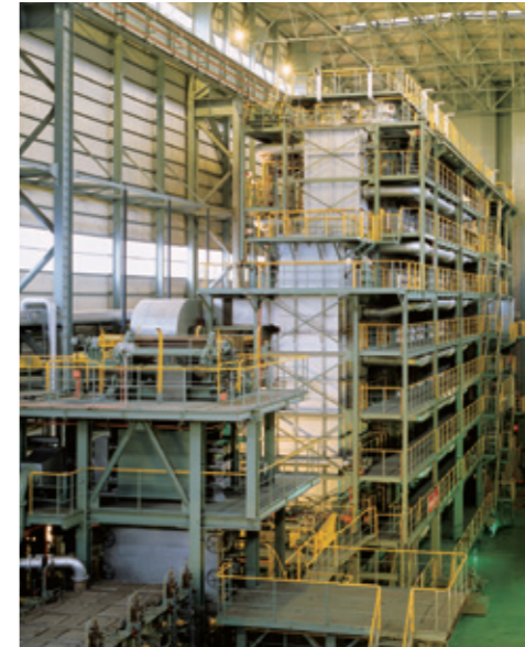
溶融亜鉛めっき設備
