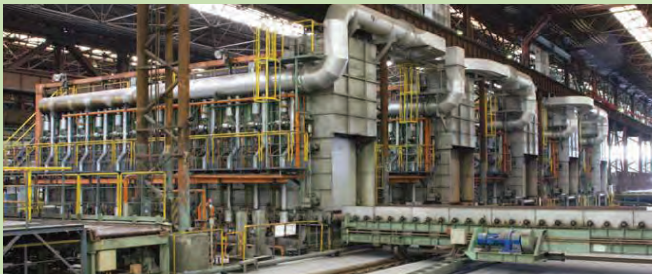
▲熱処理炉(バッチ式焼鈍炉)
