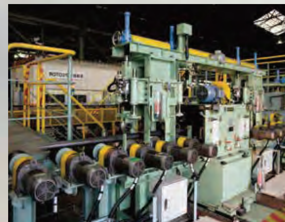
▲漏洩磁束探傷装置
