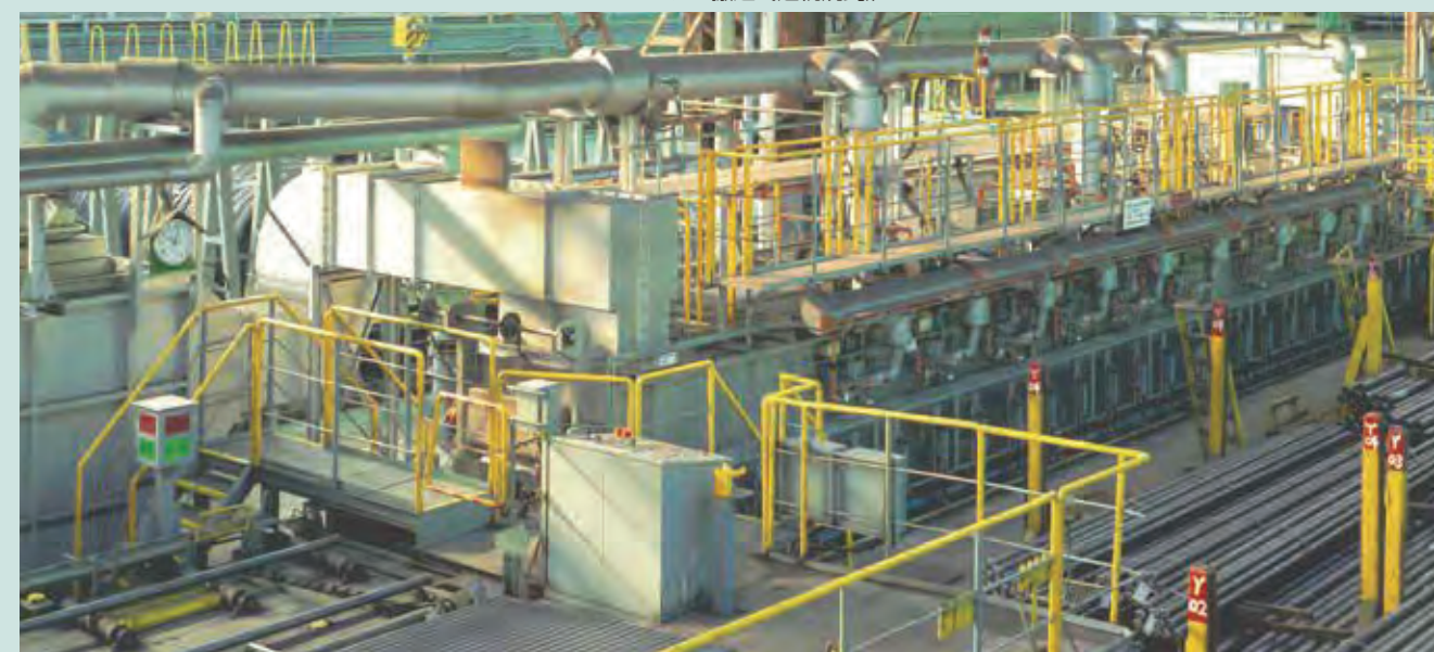
▲ローラー搬送式焼入炉
