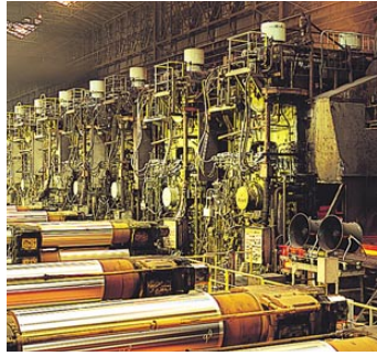
タンデム熱間圧延機
