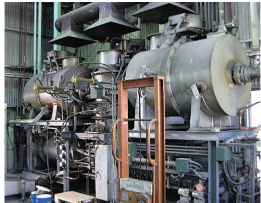
図15 ポットグレート装置 Fig.15 Photograph of pot grade
