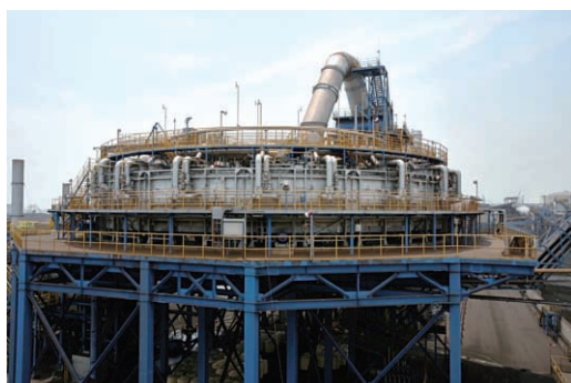
図13 JFE スチール(株)西日本製鉄所向け FASTMET 設備全景 Fig.13 FASTMET plant in JFE Steel West Japan Works (Fukuyama)
