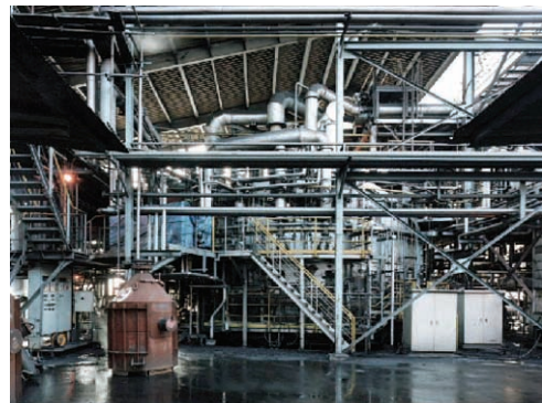
図4 加古川製鉄所FASTMETプラント Fig. 4 FASTMET plant in Kobe Steel Kakogawa Works
